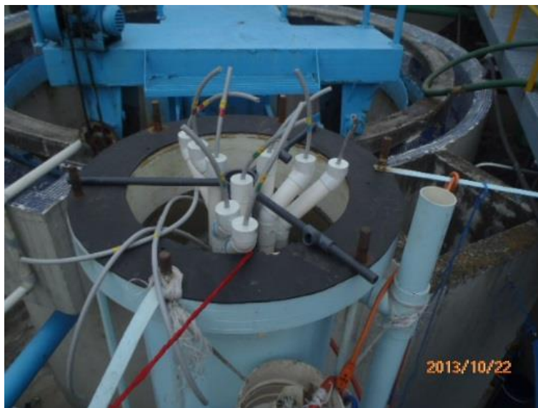
Figura 3.6 Parte superior de la estructura de soporte sumergida en el reactor
