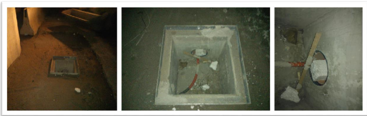
Figura 47. Espacio para instalación de acelerómetros
