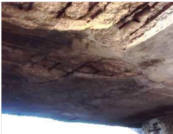
Figura 1.12. Desprendimiento del recubrimiento del concreto en la subestructura [1.3].
