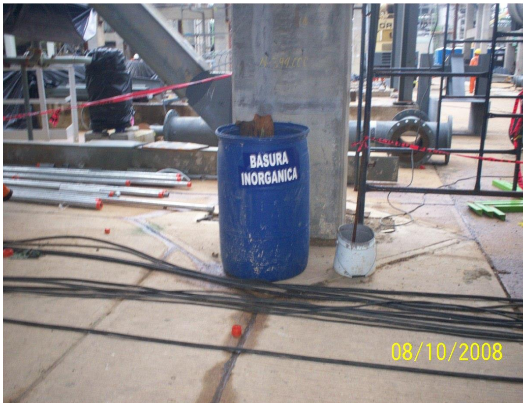
Fotografía 8.7.- Instalación de botes para recolección de basura
