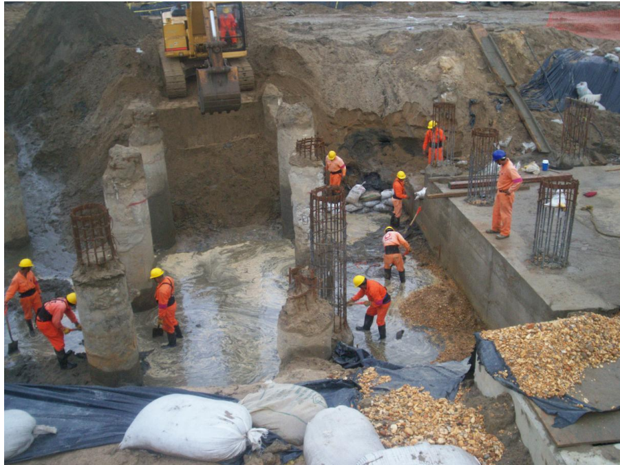
Fotografía. 7.13. - Excavación Profunda para la Construcción de Fosa de Almacenamiento de Azufre Líquido.
