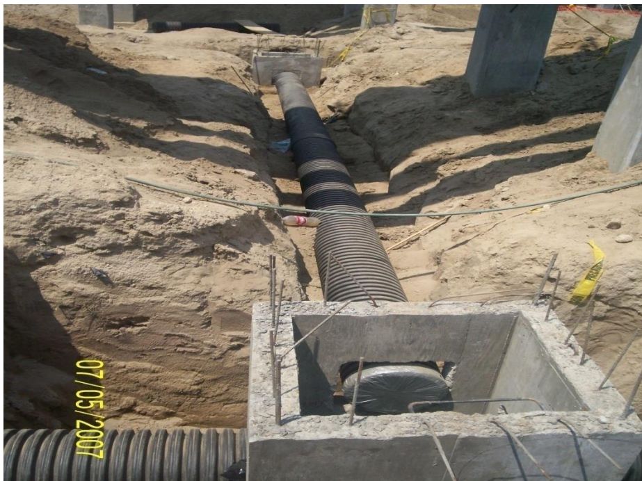
Fotografía 7.43.- Tubería de polietileno de alta densidad para el drenaje pluvial.
