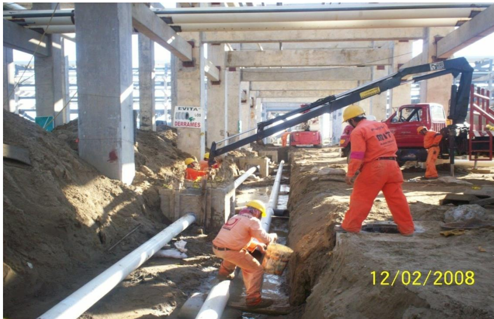
Fotografía 7.42- Tubería de acero al carbón para el drenaje químico y aceitoso.
