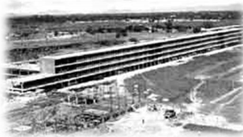
Figura 1.3 Construcción del edificio principal de la Facultad de Derecho en Ciudad Universitaria.
