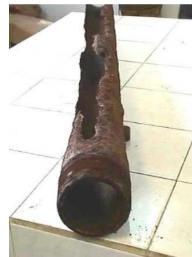
Figura 3.1.2c Efectos graves de corrosión por H 2 S
