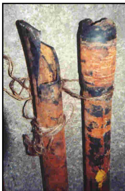
Figura 3.1.2b Efectos del SSC en tubería normada
