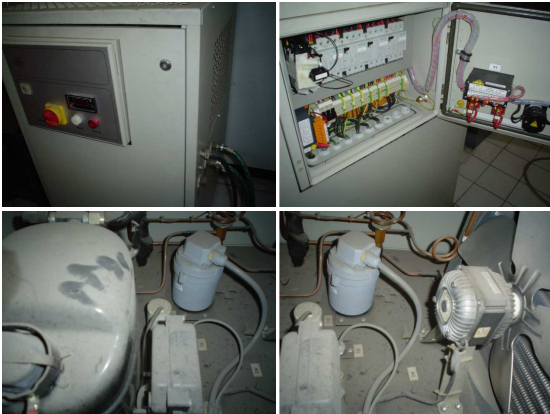
Figura 2.25 Módulo externo de enfriamiento, relevadores y tarjeta de control para el enfriamiento del agua.
