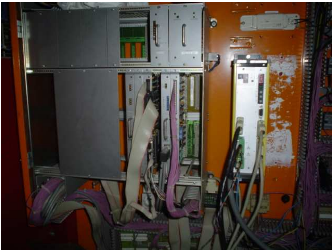
Figura 3.2 Computadora y controlador del motor encontrados en la máquina CNC.
