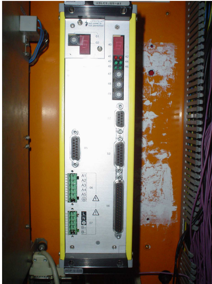
Figura 3.3 Controlador WDP 5-228 empleado para mover los motores encontrados en la máquina CNC EMCO Ls140.
