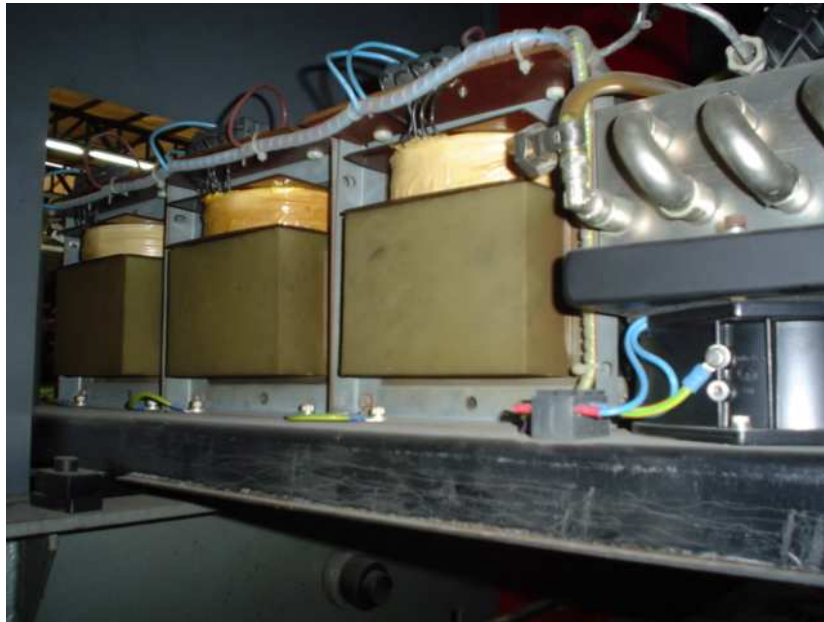
Figura 2.4 Transformadores de la máquina CNC EMCO Ls140.
