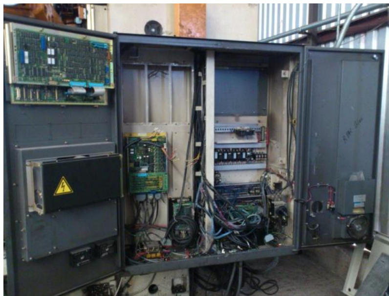
Fig. 4 Gabinete del centro de maquinado MAKINO al inicio del proyecto.
