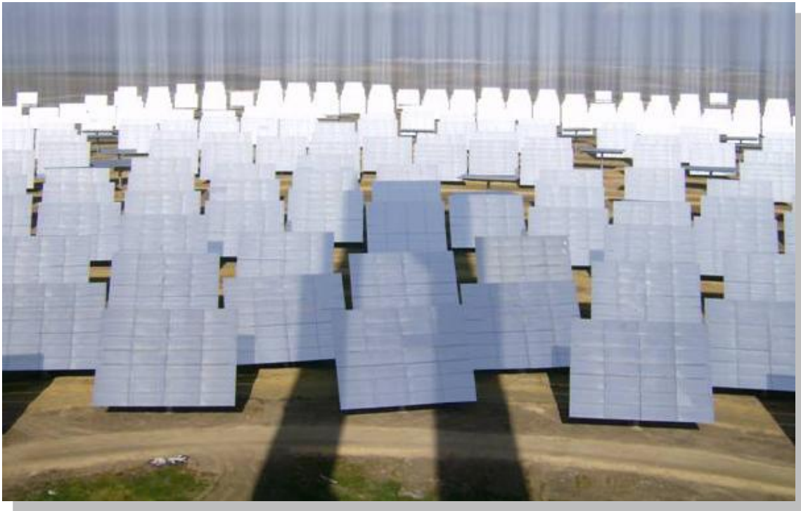
Figura No. 3.10 624 Helióstatos Sanlúcar de 120m 2 C/U reflejan los rayos del Sol hacia la torre de la PS10. Fuente: ABENGOA SOLAR, http://www.abengoasolar.es , 2009.
