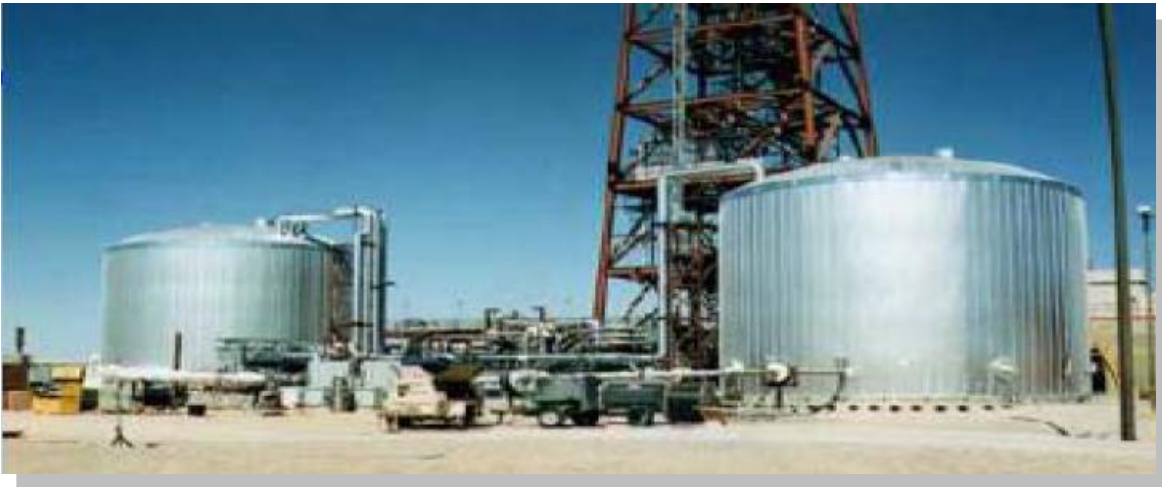
Figura No. 3.16 Sistema de almacenamiento de sales fundidas utilizado en la planta Solar Tres Fuente: Situación actual de proyectos termoeléctricos a escala mundial, ARIES Ingeniería y Sistemas, 2008.
