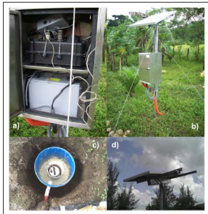
Figura 2.3. Instalación de la estación sismológica temporal. a) Gabinete con el controlador de carga, el digitalizador, le controlador del sensor y la batería. b) Soporte con el gabinete y el panel solar. c) Interior del barril con el sensor. d) Panel solar y receptor GPS. Tomada de Melgar Moctezuma (2009).
