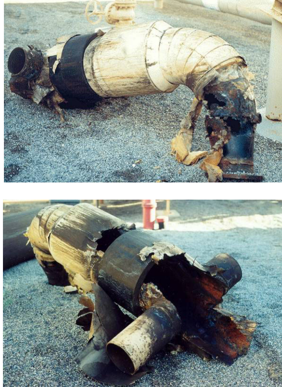
Figura 3.23 Respiraderos de vapor corroídos. Fuente: National Renewable Energy Laboratory (NREL).
