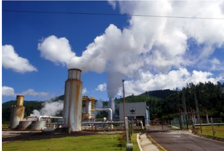
Figura 3.5 Central Geotermoeléctrica “Cerro Prieto”. Fuente: Instituto de Investigaciones Eléctricas (IIE).
