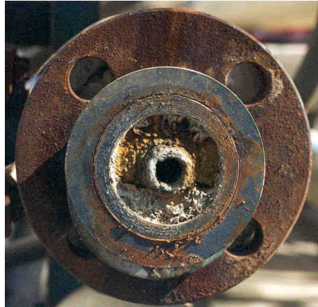
Figura 3.24 Tubería corroída y con incrustaciones. Fuente: NREL.
