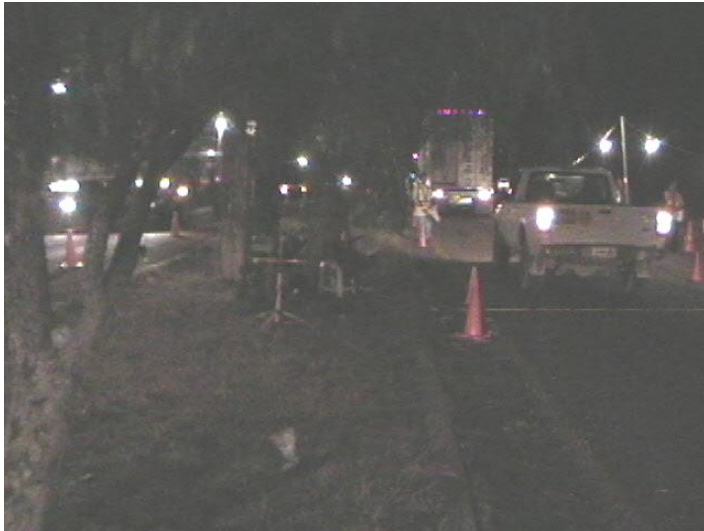
Estación OD Aeropuerto iluminación turno nocturno 04
