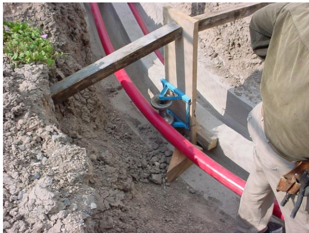
Foto 24. Guiado de cable en curva
