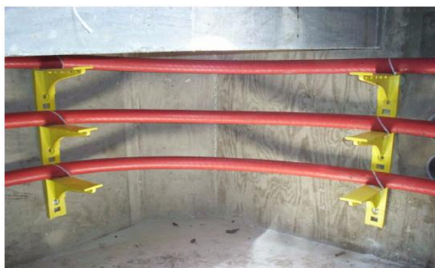
Foto 14. Ménsulas para el soporte de los cables
