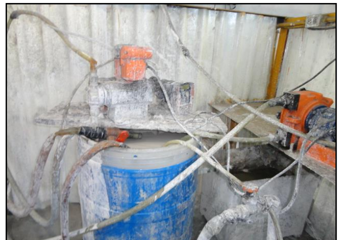
Imagen 9: Válvulas de control de suministro de reactivos químicos para el proceso de beneficio
