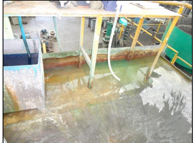
Imagen 7: Fuga de reactivos químicos para el proceso de beneficio
