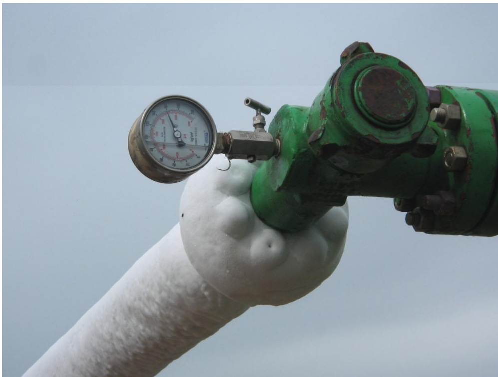
Fig. 215.- Efecto de congelamiento del bajante debido a un efecto extremo Joule-Thompson.
