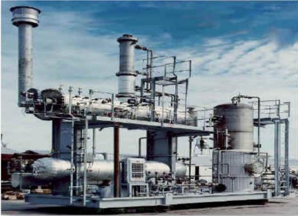
Fig. 42.- Torre contactora para regeneración del glicol y deshidratación del gas
