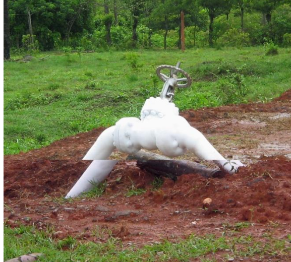
Fig. 218.-Congelamiento de la válvula de seccionamiento.
