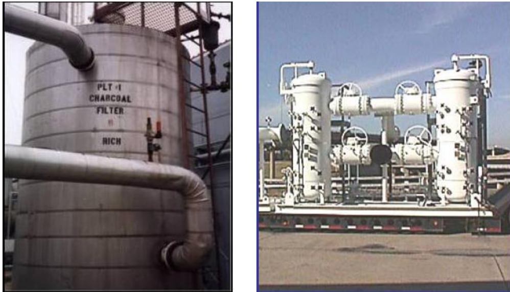
Fig. 44.- Filtros de glicol
