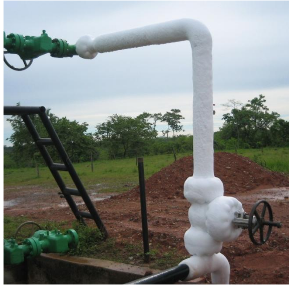
Fig. 216.-Bajante y parte del cabezalito congelado. Fuente.- Coordinación de Construcción y Mantenimiento. A.I.M.
