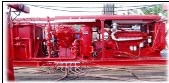
Figura 2.20 Booster Empleado en Operaciones de Perforación con Espuma.
