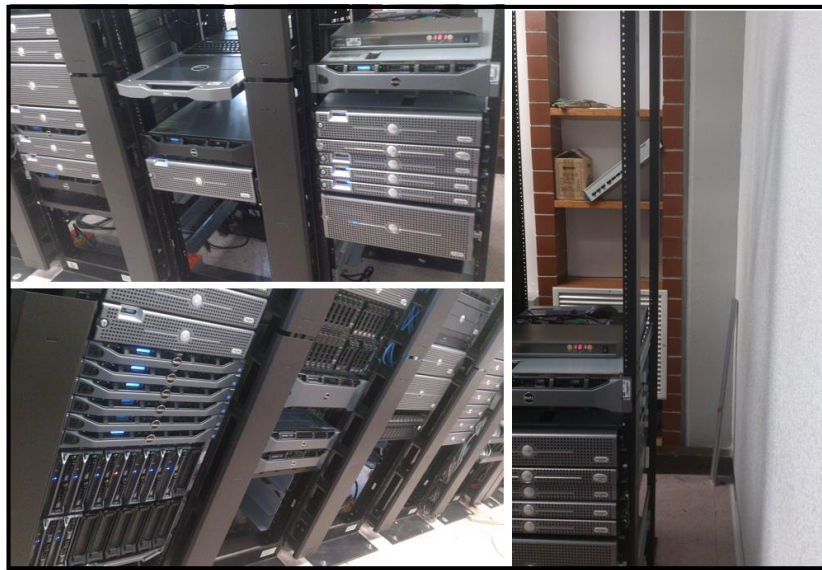
Figura 45 Fotografía de algunos elementos de cómputo y un pasillo lateral.
