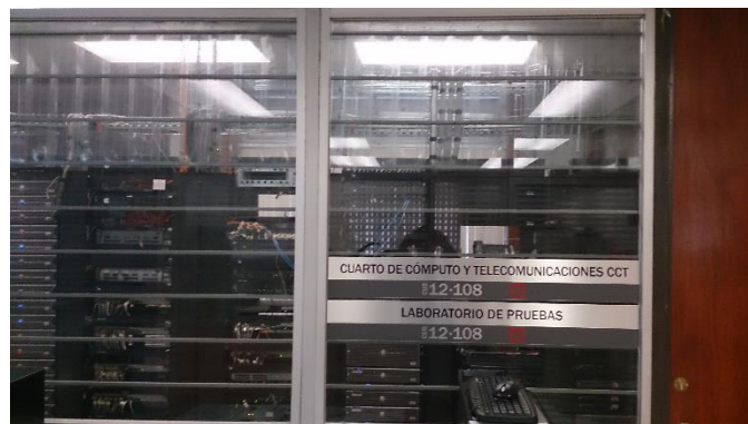
Figura 39 Cuarto de cómputo y telecomunicaciones CCT.
