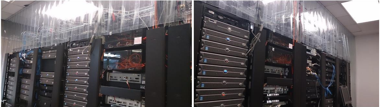
Figura 77 Fotos del frente del clúster con las cortinas de pvc en el techo.
