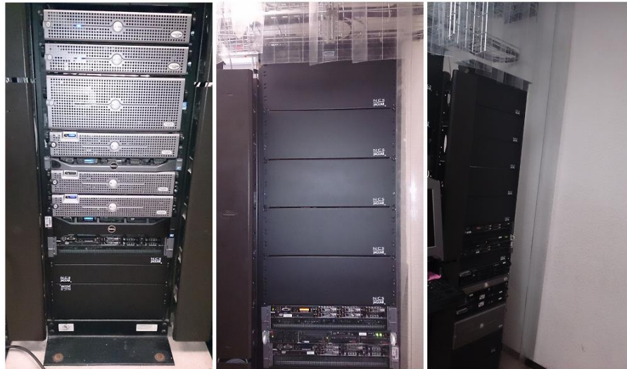
Figura 78 a) Módulo 9 con el piso bloqueado b) Módulo 1 con el espacio de arriba bloqueado c) Cortina utilizada en el pasillo lateral.
