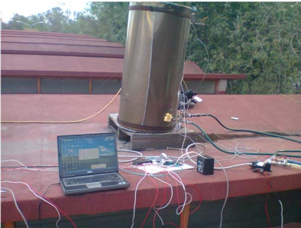
Figura 63: Termotanque y conexiones
