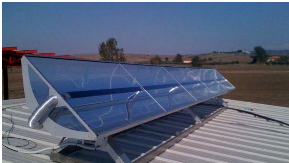
Figura 19: Colector solar de concentración
