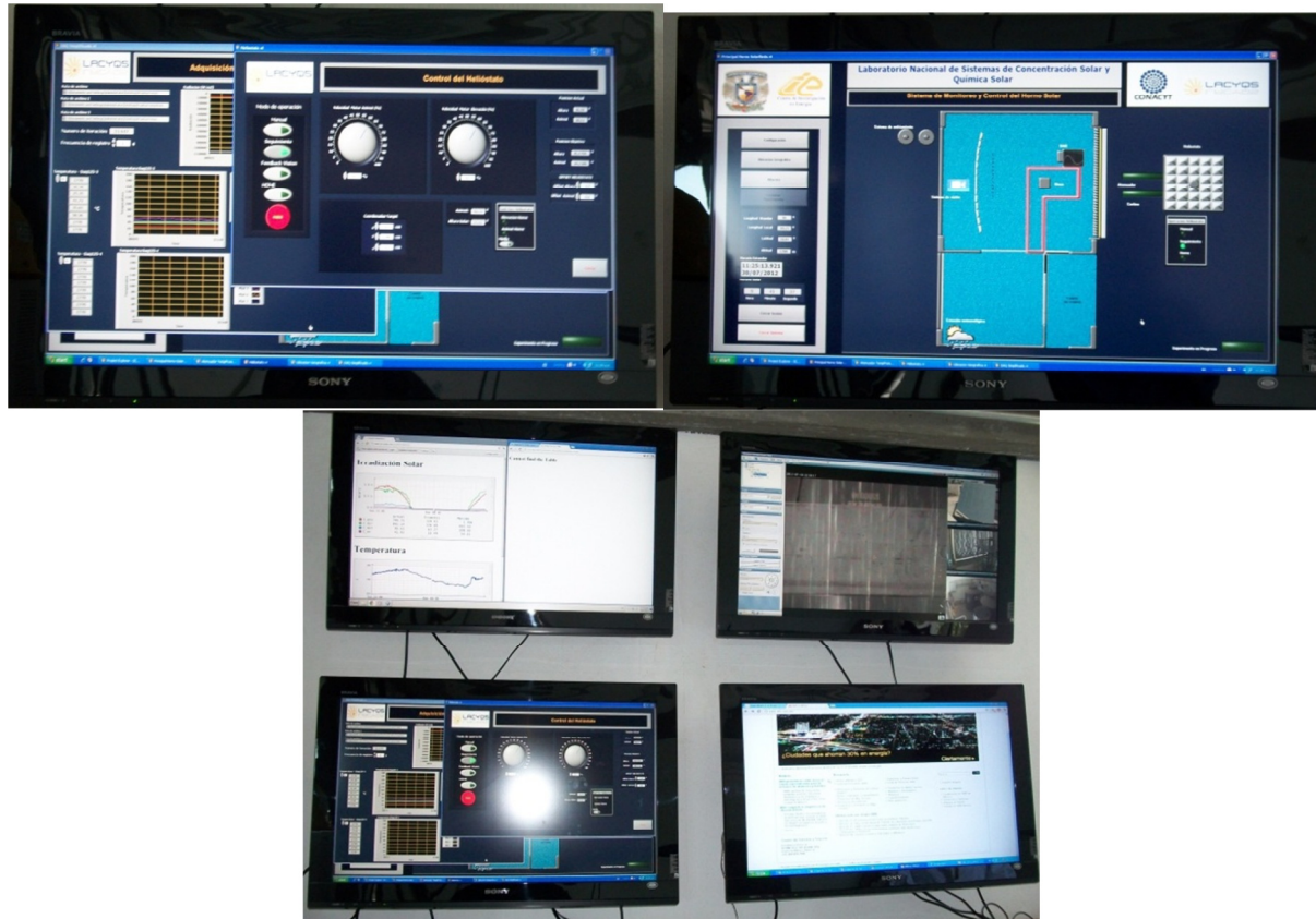
Fig. 2.20 Fotografía del cuarto de control en el HSAFR
