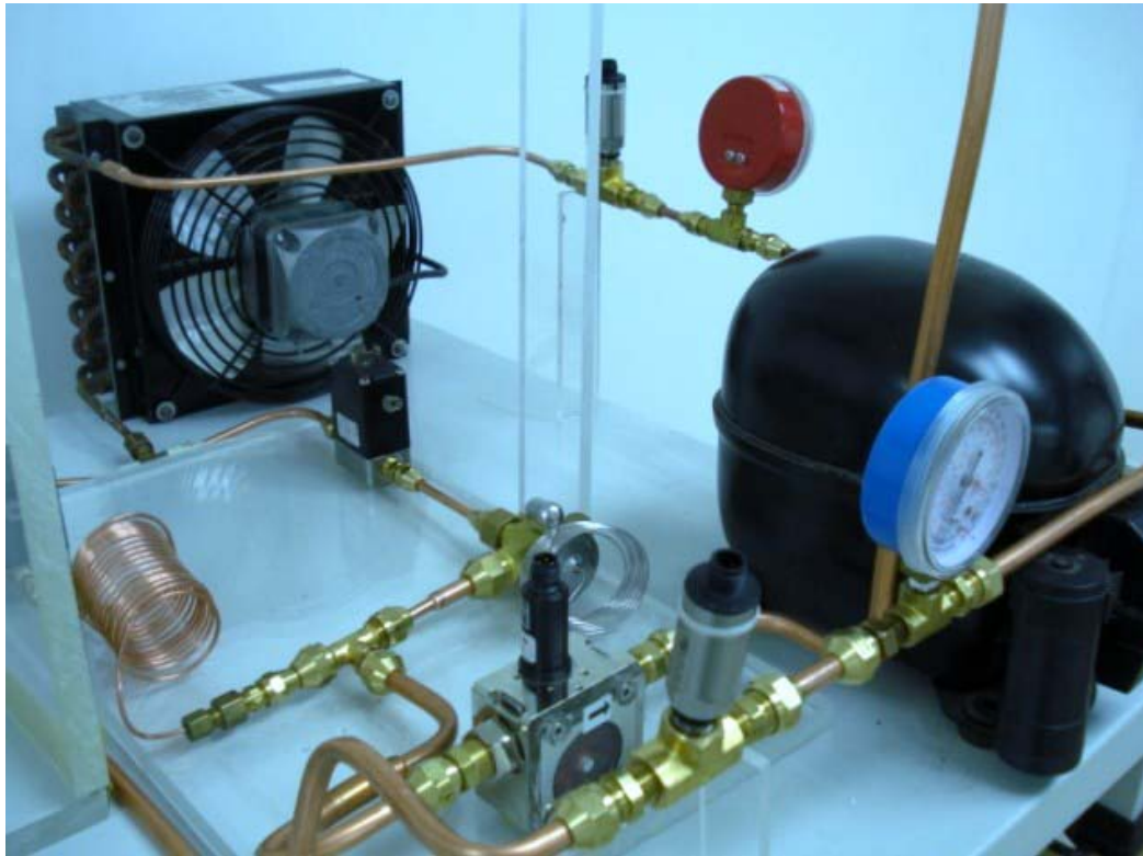
Figura 28. Arreglo de la instrumentación en el circuito de refrigeración.
