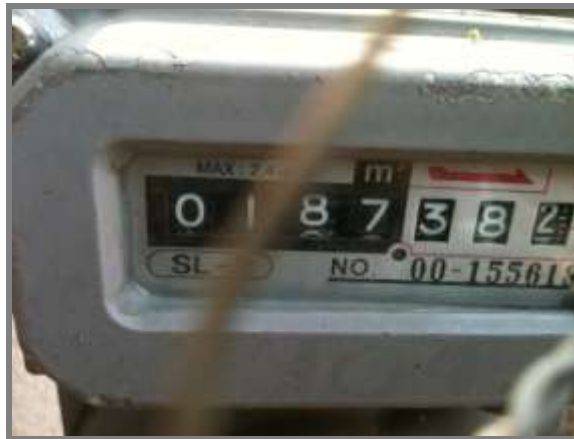
FIGURA 3.10. MEDIDOR DE GAS
