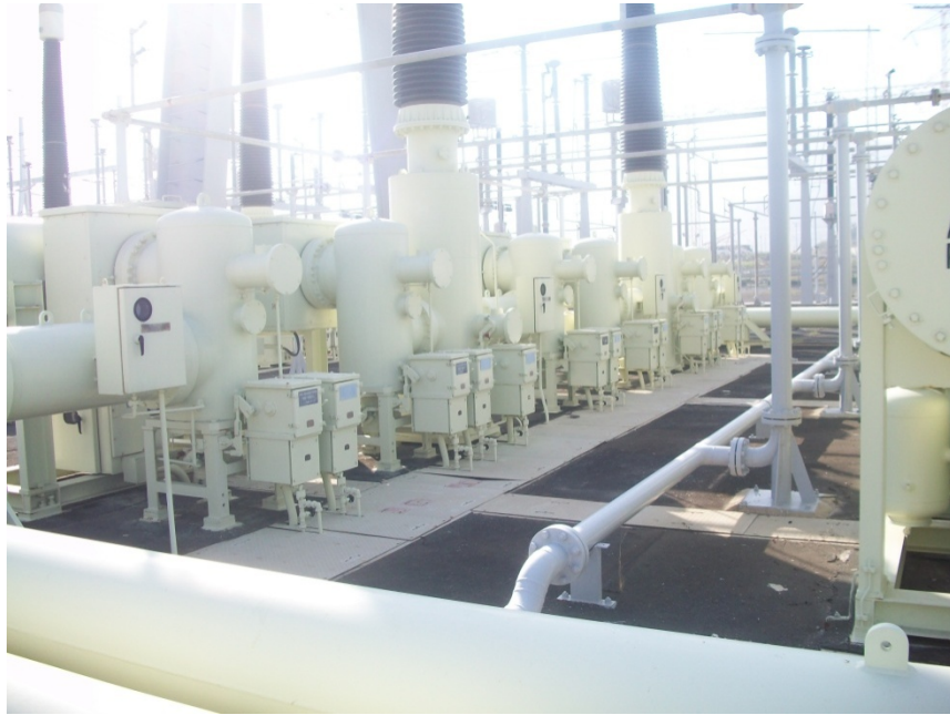
Fig. 5.- Fotografía Subestación Laguna Verde 230 kV
