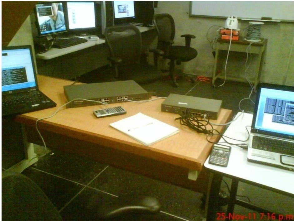
Figura 3.11. Implementación física de la red con cable UTP utilizando un cliente y un servidor
