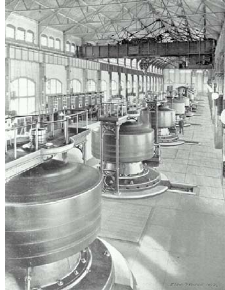
Figura 1. 29 Primeros generadores polifásicos instalados en Niágara
