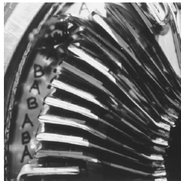
Figura 9.7. Acercamiento de las piezas de cobre que se utilizan para interconectar los extremos finales de las bobinas del estator.
