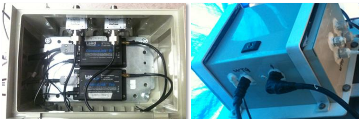
Figura 21. Módulo de comunicaciones.
