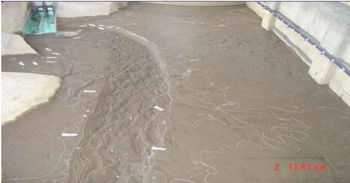
Figura 1.14 Fotografía Embalse colmado de azolve. Se aprecia el funcionamiento del desarenador. Fuente CFE (2011).
