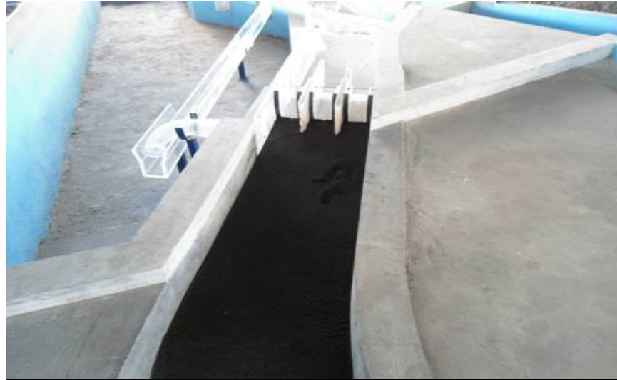
Figura 4.7 Desarenador proyectado con arena volcánica.
