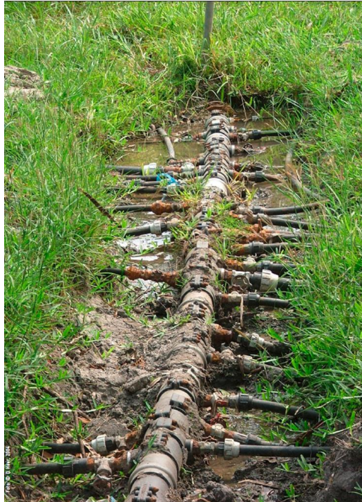
Figura 3.7 Pérdidas de agua en líneas de distribución
