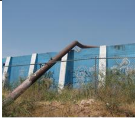
Figura 4.6 Tanque Tres Estrellas
