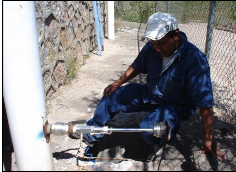
Figura 4.95 Punto de medición existente en el tanque Biznagas
