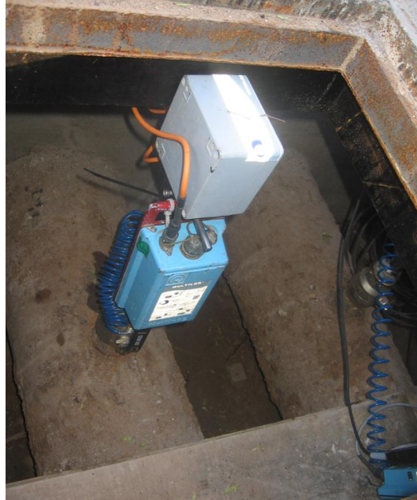
Figura 3.6 Medición de caudal con medidor electromagnético de inserción
