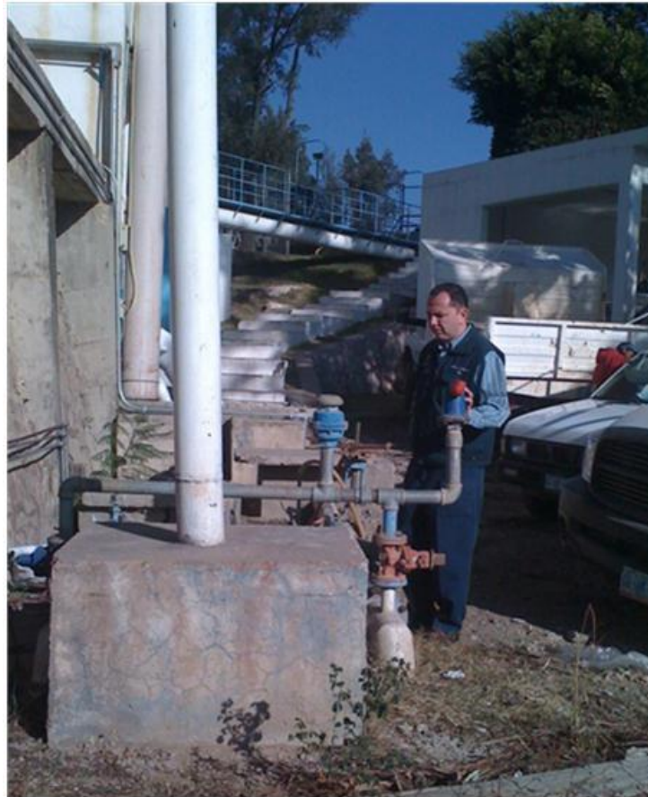
Figura 2.2 Llegada a tanque Filtros
