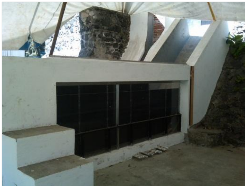
Figura 3.5 Tanque amortiguador con la pared de acrílico
