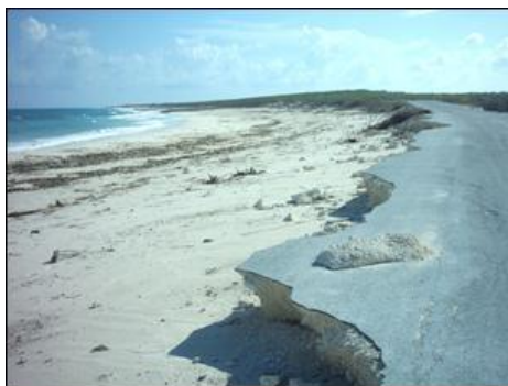
Fig.4.20 Deterioro de un tramo de vía paralelo a la costa debido a la erosión en la isla de Cozumel. Fuente: Internet.
