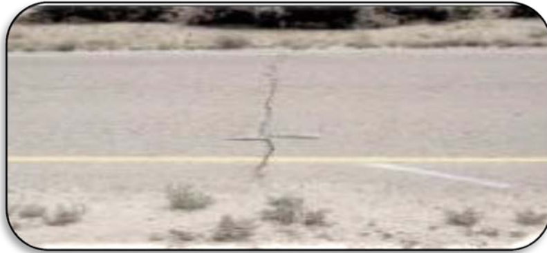
Fig. 4.1.1.1 Agrietamiento por baja temperatura
