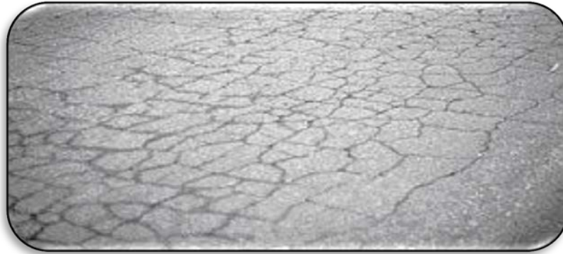
Fig. 4.1.2.1 Agrietamientos por fatiga
