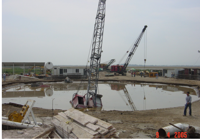
Figura B.1.31. Falla de la Lumbrera 6 del Interceptor Río de los Remedios
