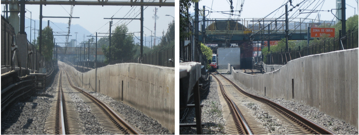
Figura B.1.54. Deformación del cajón de la Línea A del metro de la ciudad de México atribuible al fenómeno de hundimiento regional
