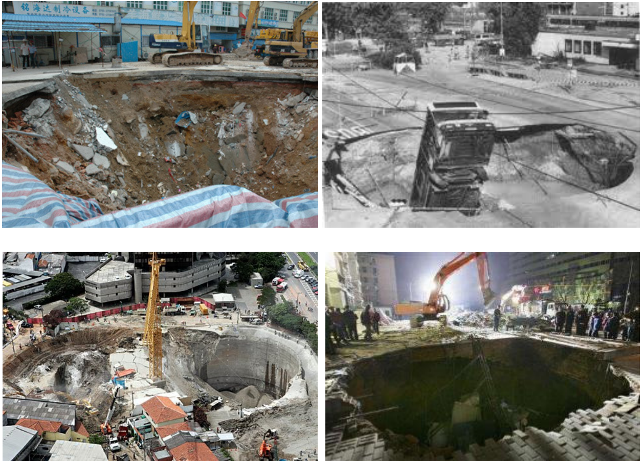
Figura B.1.18 Ejemplos de daños en superficie ocasionados por fallas de frente durante la construcción del túnel
