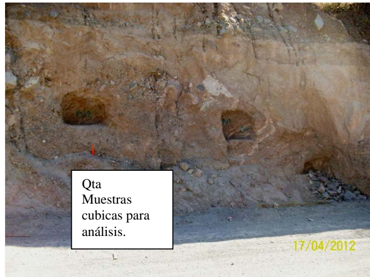
Fig 57. Cadenamiento 3+240, se observa material alterado superficialmente, lo que propiciará en la época de lluvias erosión.
