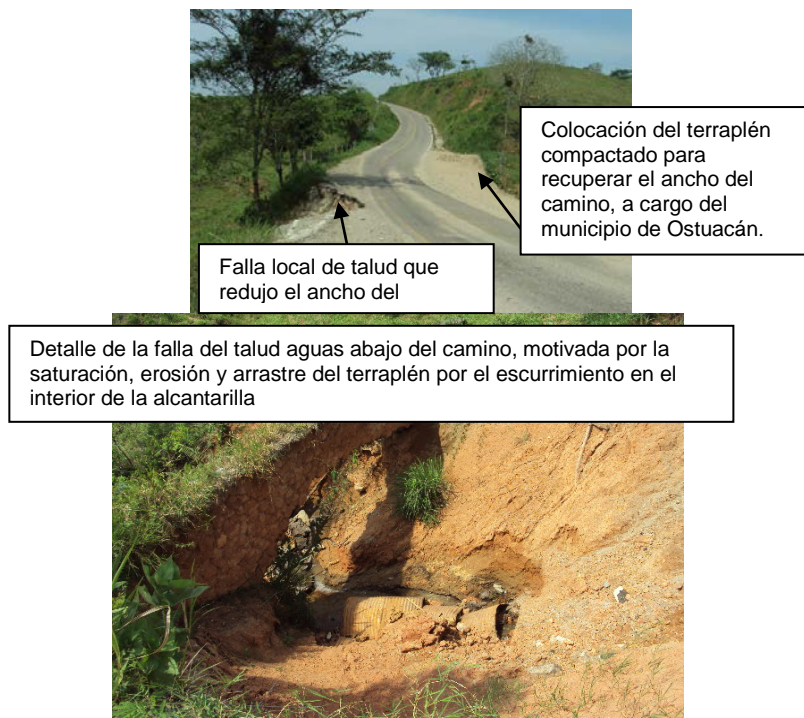
Fig 37-38. Falla del camino entre la obra de excedencias de la presa Peñitas y el dique Micos. La reparación estuvo a cargo del Municipio de Ostucán, Chis.
