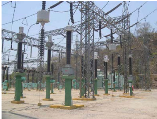
Fig 12. Subestación exterior de la CH La Villita, Mich.
