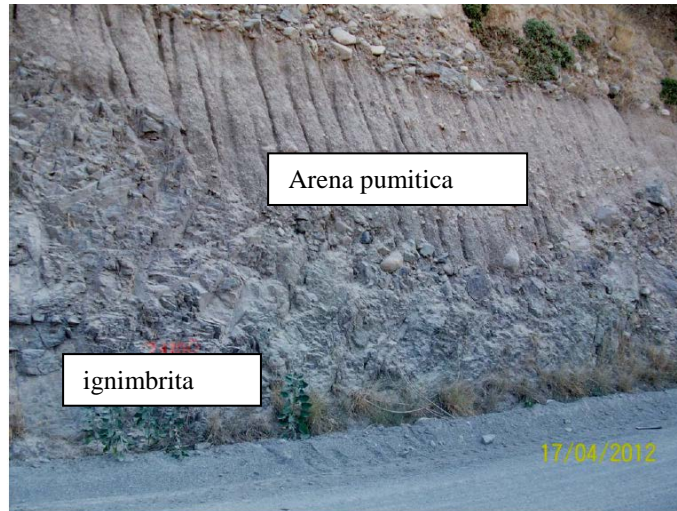
Fig 55. Cadenamiento 3+240, se observa material alterado superficialmente, lo que propiciará en la época de lluvias erosión.
