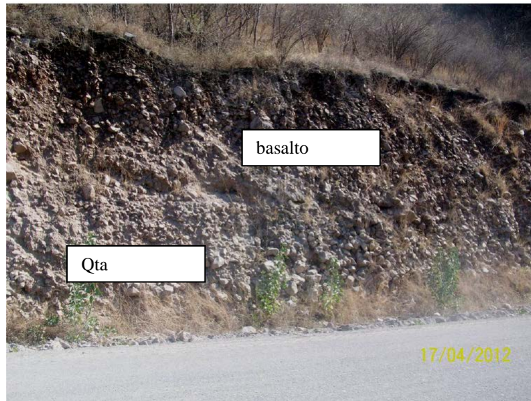
Fig 56. Cadenamiento 3+560, se observa material alterado superficialmente, lo que propiciará en la época de lluvias erosión.
