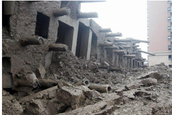
Figura 6.1. Las construcciones presentan asentamientos y desplomes, causa de las acciones sísmicas.
