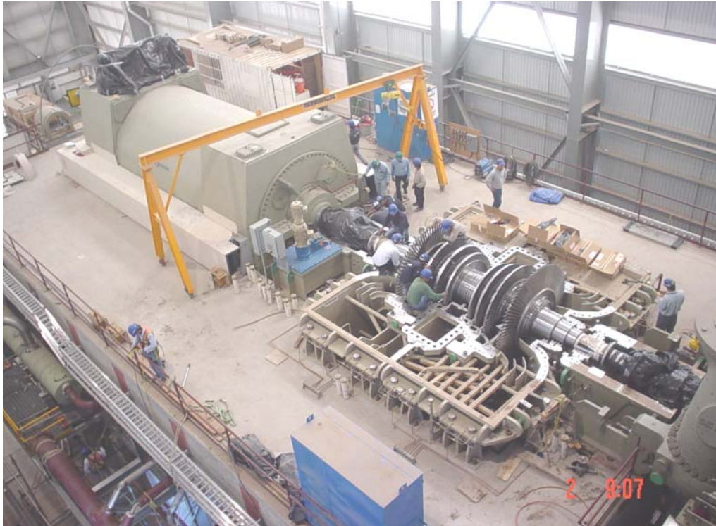
Fig. 3.2 Instalación de turbina de vapor (peso aproximado 700 t; turbogenerador, turbina baja presión (colocándole alabes) y turbina alta presión a la derecha (visible parcialmente)
