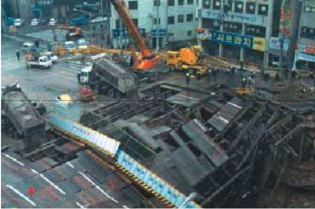
Fig. 2.5 Falla en el metro de Taegu, por la fluctuación rápida de agua sobre los muros Milán, originalmente no considerada.
