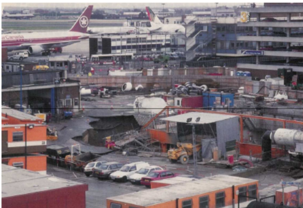
Fig. 2.3 Vista general de la falla en el Aeropuerto de Heathrow, Inglaterra, 1994
