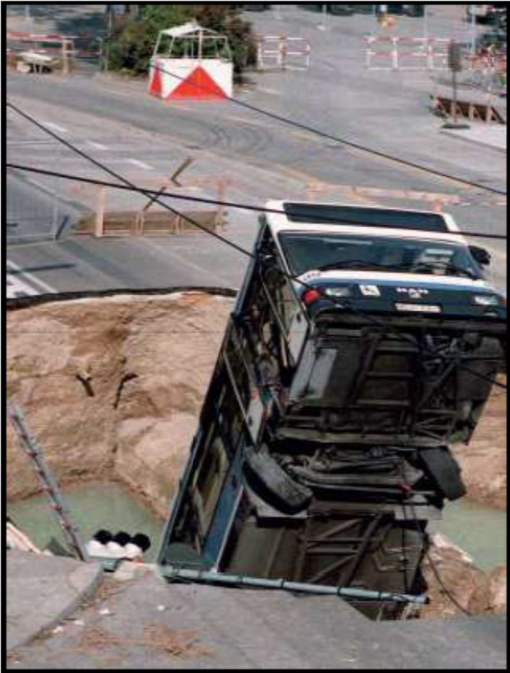
Fig. 2.2 Fotografía en donde se puede apreciar la presencia de la filtración del agua, causante de la falla.
