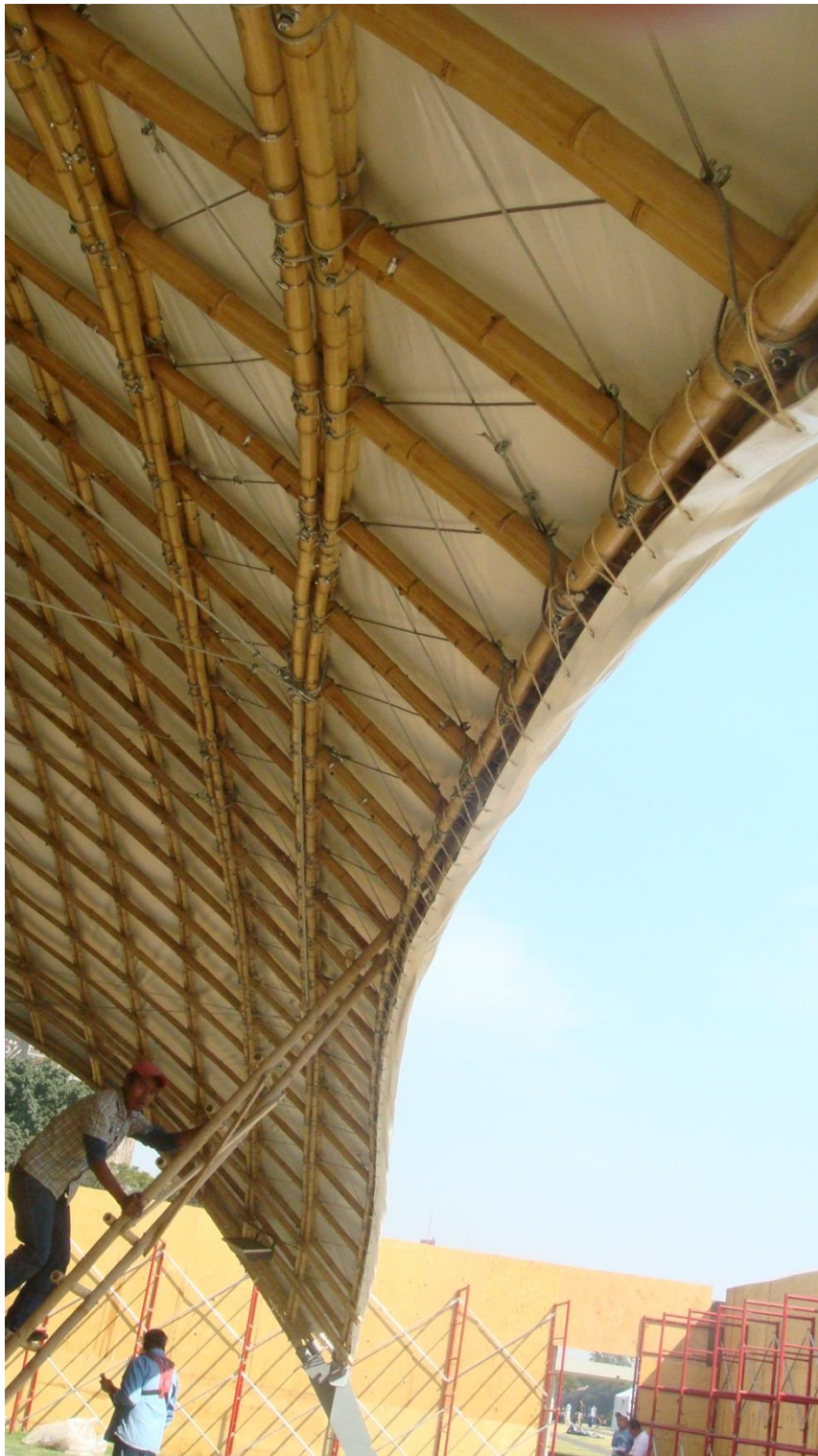
Figura A.6 Borde distorsionado, donde se observa las diagonales de refuerzo
