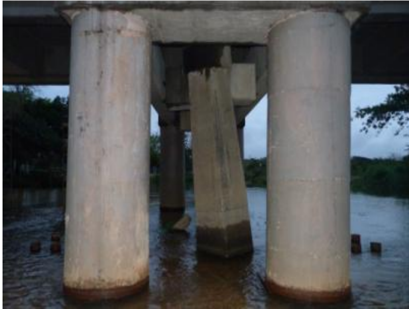
Fig. 3.33 Detalle de sustitución de apoyos por falla de los anteriores
