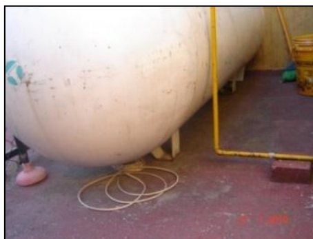
Figura 5.11 Tanque de gas instalado en azotea
