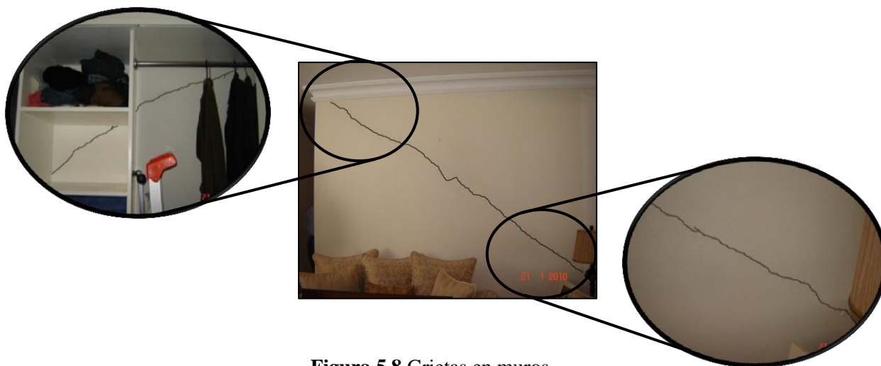
Figura 5.8 Grietas en muros
