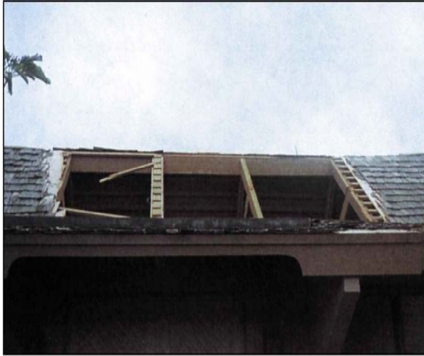
Fig. 5.3.2.- El huracán Niki (1992), Condado de Kauai, Hawái. Pérdida del revestimiento del techo debido a un diseño inadecuado clavado de la madera.
