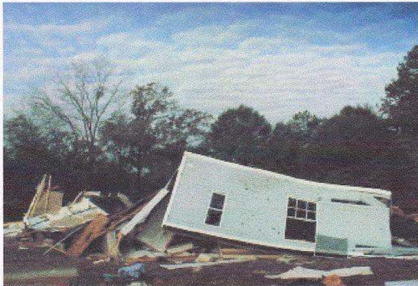
Fig.4.2.3.- Caseta ligera prefabricada en Horizontal County, Alabama, Estados Unidos de América, volcada por los vientos de un tornado (Ray Phillips; Horizontal County, Alabama USA, 11/25/2001; Fotografía tomada de FEMA News Photo)
