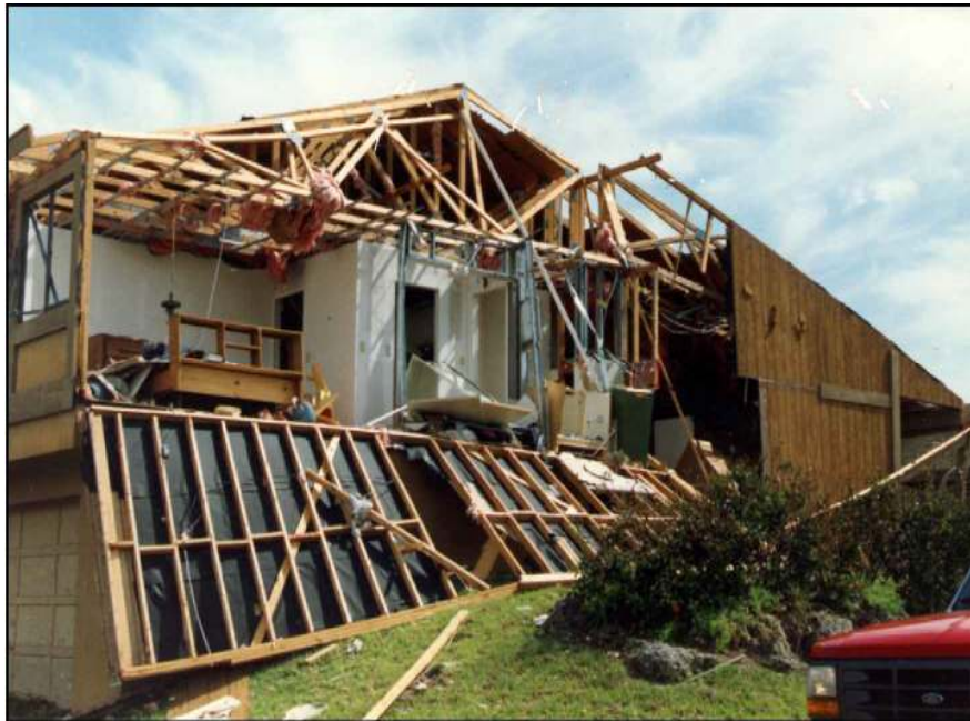
Fig. 5.3.1 El huracán Andrew (1992). Destrucción de la pared típico fracaso de la primera planta de estructura de madera del edificio en Dade County,
