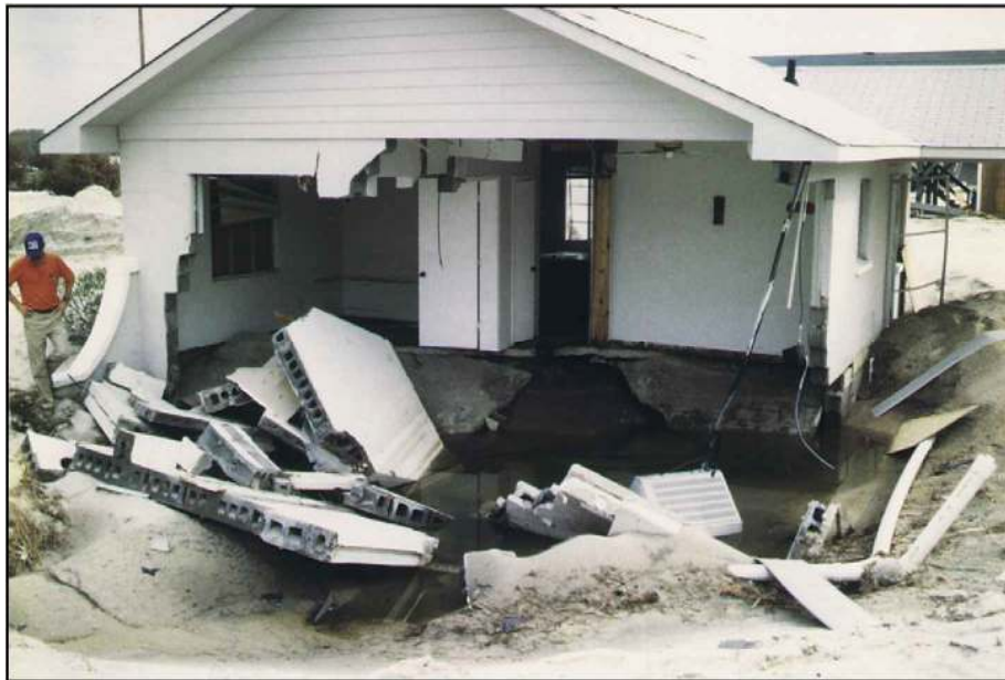
Fig. 5.3.3.- El huracán Fran (1996). Caso extremo de socavar la cimentación localizada en una casa de losa sobre el grado en Topsail Island, Carolina del Norte.
