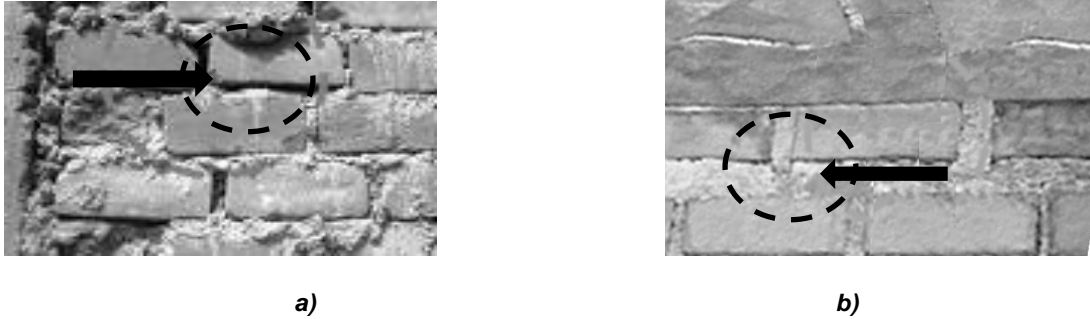
Figura 3.8 Espesores de junta a) menor al solicitado b) mayor al solicitado en las NTCM (CAA, 2013)
