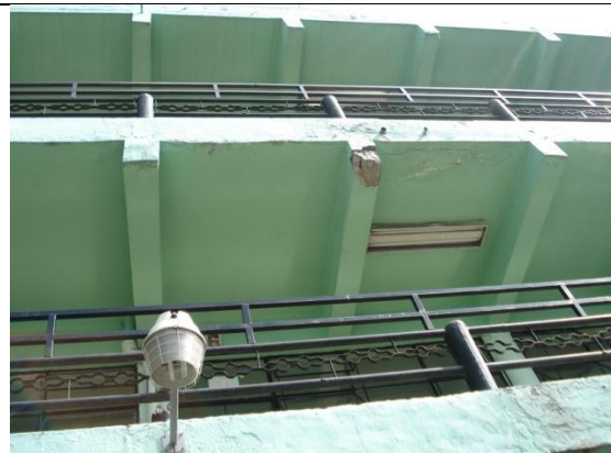
Ilustración 4 Agrietamiento en vigas
