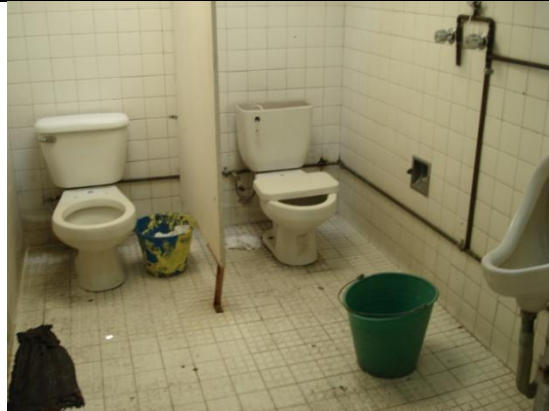
Ilustración 10 Núcleos sanitarios al final de su vida útil
