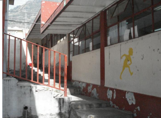
Ilustración 20 Ligero agrietamiento en muro
