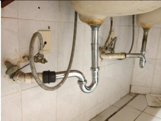
Ilustración 9 Instalaciones hidrosanitarias en mal estado
