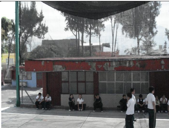
Ilustración 21 Acabados en mal estado
