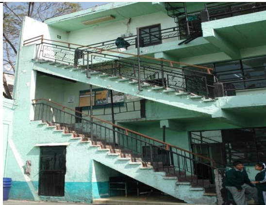
Ilustración 5 Pasillos y escaleras no cumplen con dimensiones
