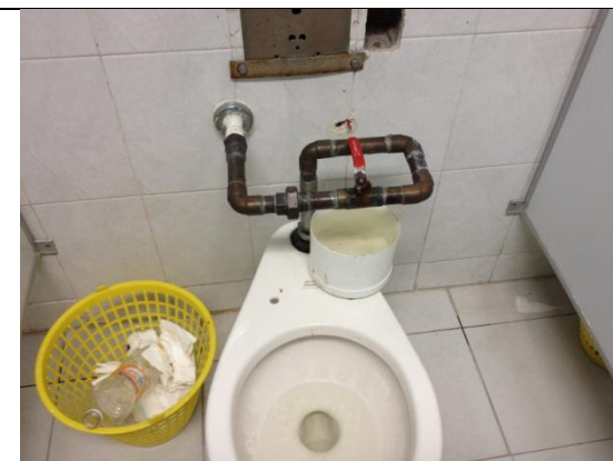
Ilustración 18 Filtraciones en tuberías
