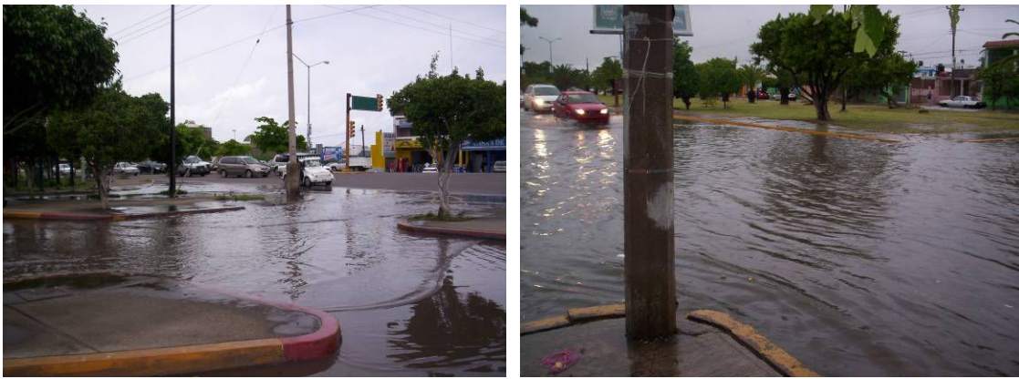
Figuras 3.3 y 3.4. Inundación completa de cruceros.
