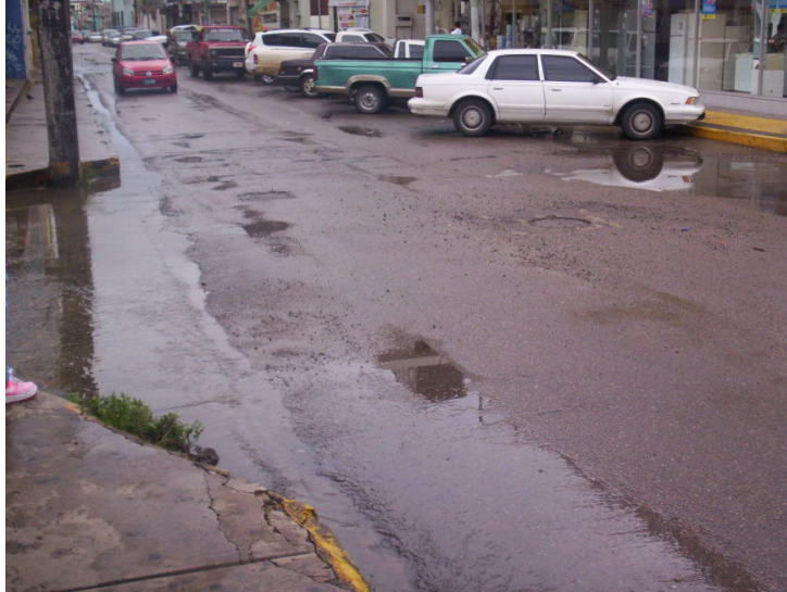
Figura 3.12. El escurrimiento superficial se lleva a cabo por la orilla de ciertas avenidas debido al constante re-encarpetamiento de las mismas.
