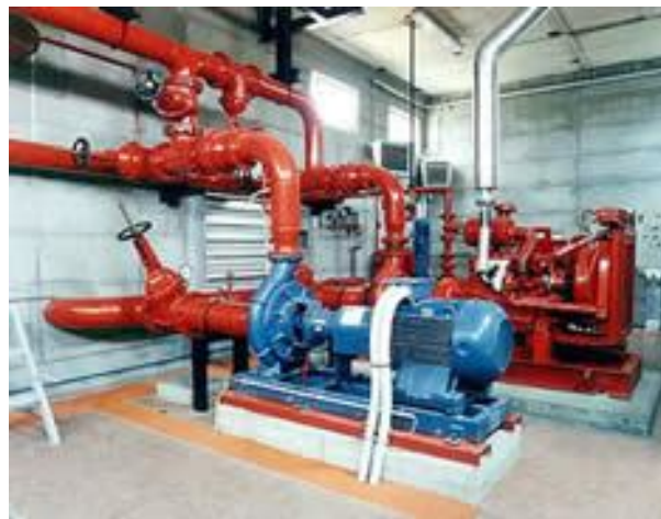
Figura 2.1. Bomba contra incendios.
