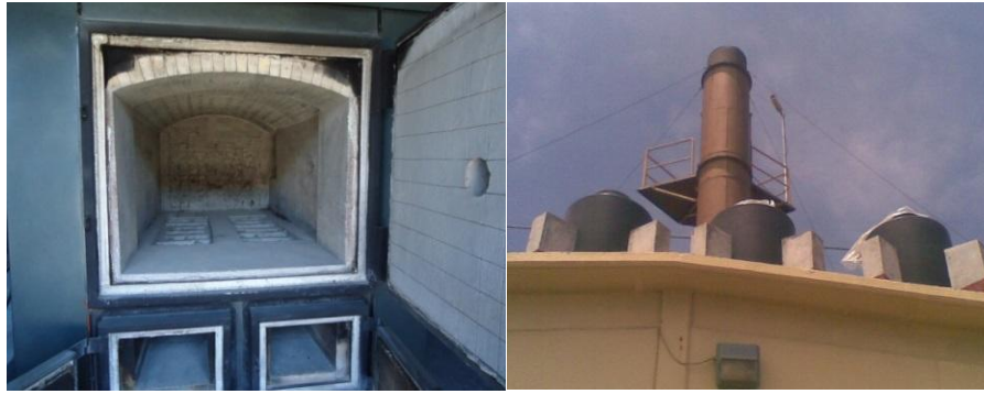
Figura 4.65 Cámara de ignición y chimenea
