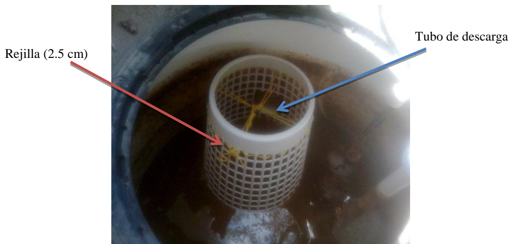
Figura IV-4. Rejilla del cárcamo de bombeo
