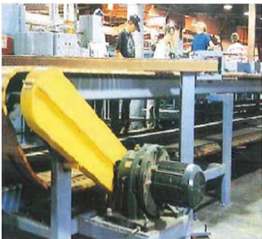
Figura 1.10. Industria de la madera: Reductores para accionamiento del transportador. La gran capacidad de sobrecarga, funcionamiento sin mantenimiento y seguridad contra las averías fueron ventajas decisivas.
