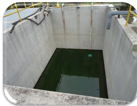
Tanque de igualación de caudales
