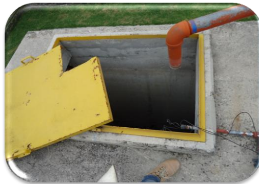
Cisterna de agua tratada
