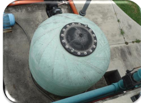
Filtro de arena a presión seguido de cloración
