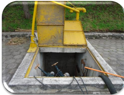
Cárcamo de recepción (3 colectores)
