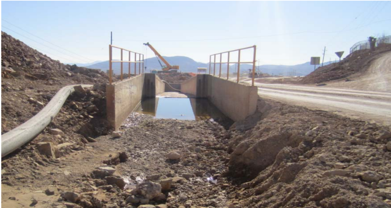
Imagen 1: Obra de toma, Cadenamiento 00+ 000.
