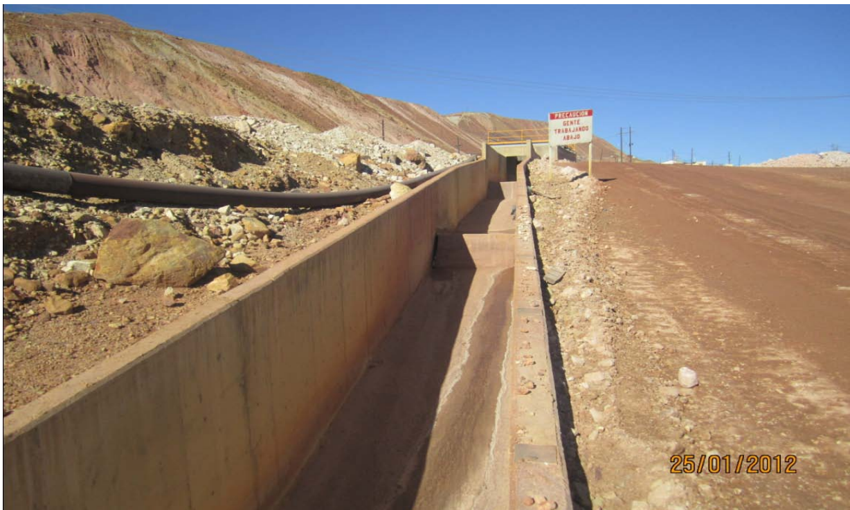
Imagen 12: Reductores de velocidad RV-1 RV-2 en el canal de concreto, Cadenamiento 00+ 550
