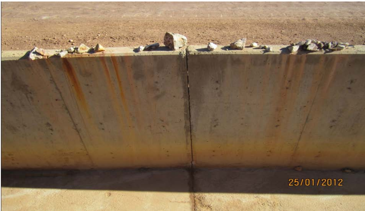
Imagen 4: Marca en el muro del canal de concreto dejadas por avenidas de agua pluvial, con un tirante de aproximadamente 40 cm, Cadenamiento 00+ 130.
