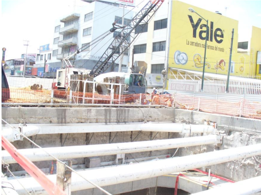
Troqueles deteniendo al muro Milán mientras se efectúan los trabajos de relleno y compactado (Imagen: I-XIII)
