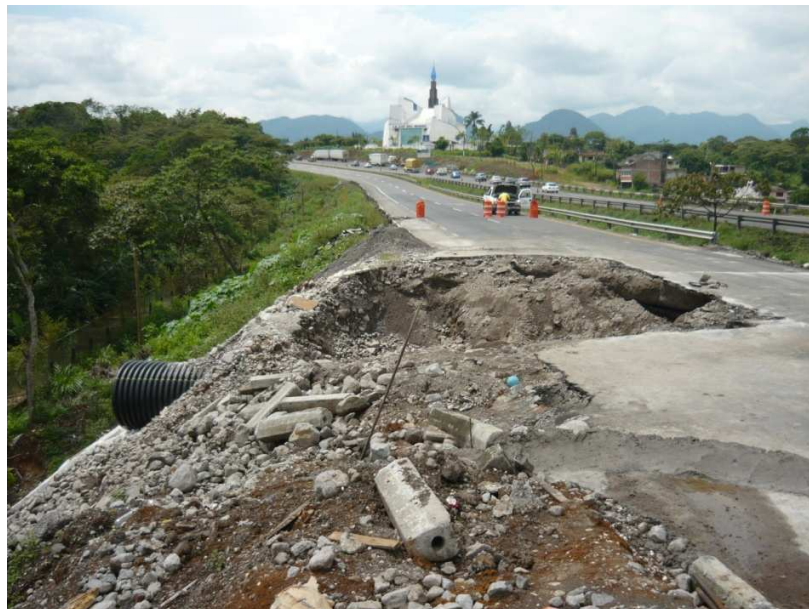
FOTO 1b.1 Plano general de la falla sobre el cuerpo B de la autopista Veracruz – México km 286+950.
